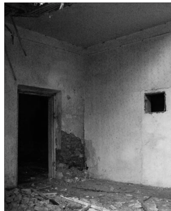
Zniszczone wnętrza. Fot. Magdalena Grassmann.
