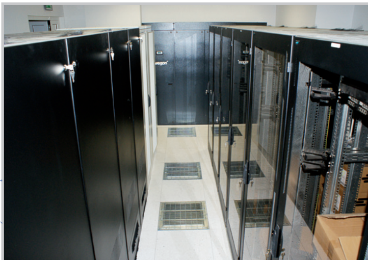
Serce obiektu - serwerownia (jeszcze pusta)
