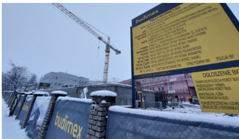
29 grudnia 2023 r. - budowa klinik zakaźnych w szpitalu na Dojlidach. Budowlańcy pojawili się tu we wrześniu, fot. Wojciech Więcko
