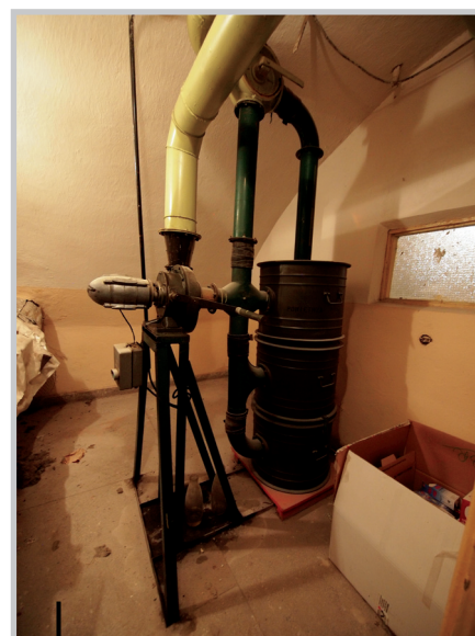
W 20-leciu międzywojennym w piwnicach pałacu funkcjonował schron przeciwlotniczy. Na zdj. urządzenie dostarczające powietrze do schronu.
