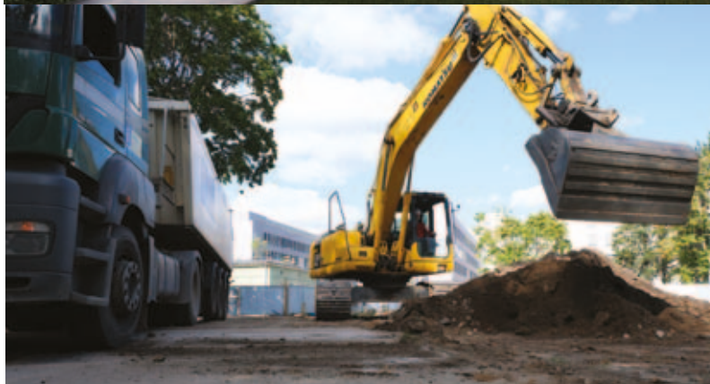
W końcu maja 2022 r. Centrum Psychiatrii ma wyglądać tak, jak na zdjęciu powyżej. Na razie trwają prace ziemne przy jego budowie (dolne zdjęcie)
